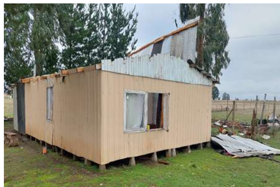
Fotografía: Vivienda Sector Pichipantano, Emergencia Sistema Frontal
